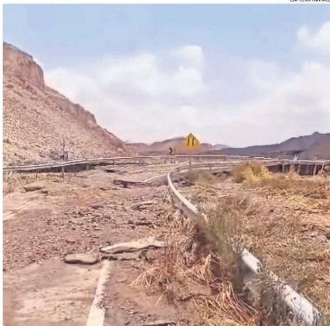
VECINOS DEL SECTOR ALERTARON SOBRE LOS DAÑOS EN EL PUENTE DEL VADO SANTA BÁRBARA.
