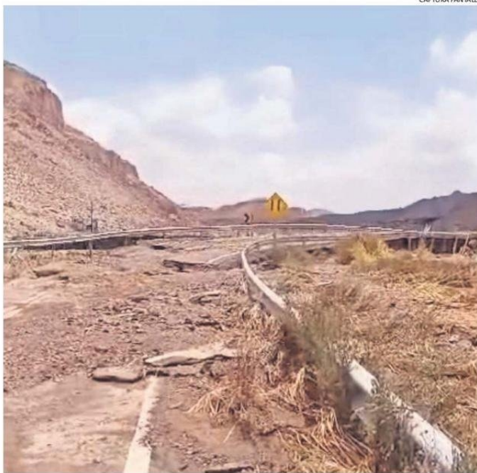
VECINOS DEL SECTOR ALERTARON SOBRE LOS DAÑOS EN EL PUENTE DEL VADO SANTA BÁRBARA.
