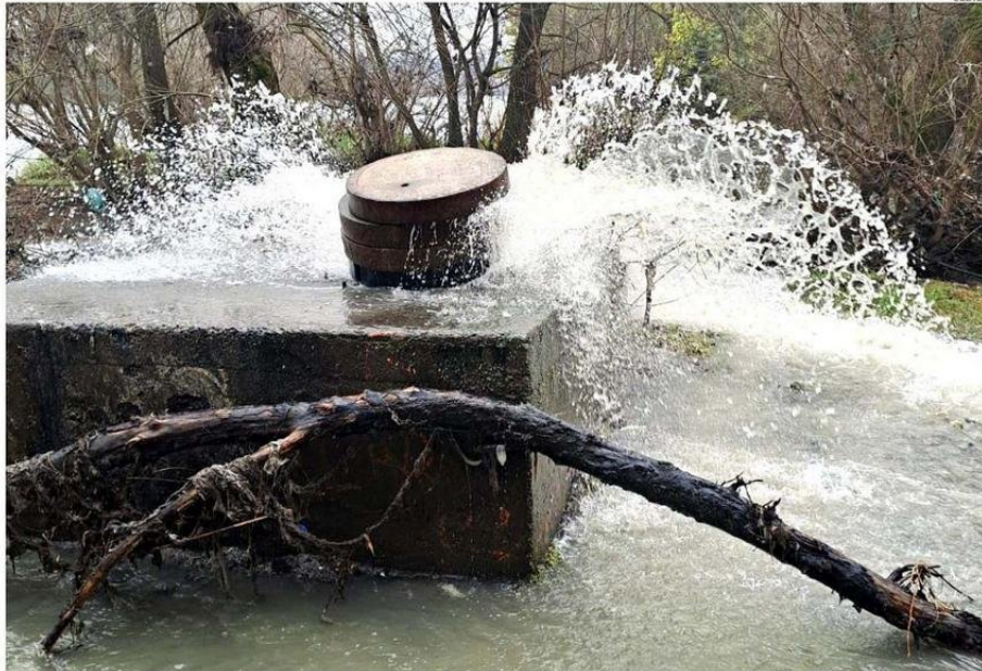
UNA IMPRESIONANTE EXPLOSIÓN DE AGUAS SERVIDAS SE VIO SALIR DESDE LA CÁMARA, TANTO EL 1 COMO EL 10 DE AGOSTO.
