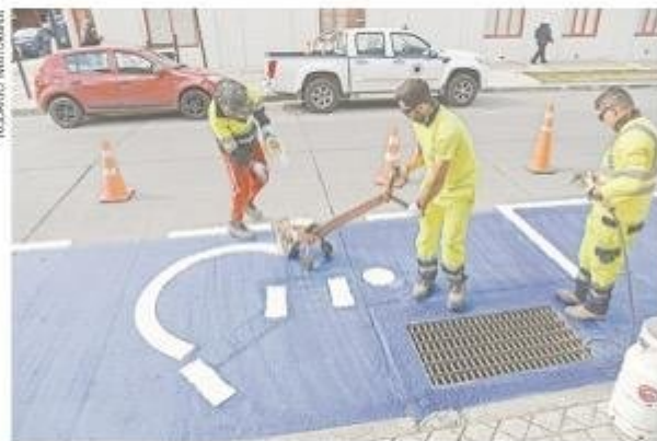
Este miércoles se ejecutaron obras de demarcación en calle Lautaro Navarro con Errázuriz.
