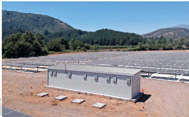
Central Cordillerilla III, una instalación PMGD fotovoltaica de 1,3 MWp.
