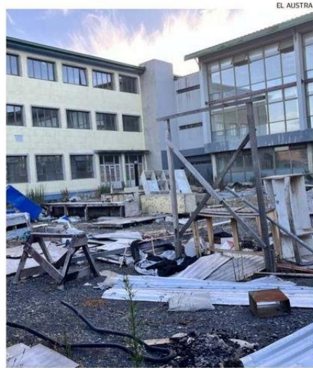
LAS OBRAS DEL LICEO CARMELA CARVAJAL ESTÁN EN TOTAL ABANDONO DESDE MAYO DEL 2022, LO QUE SE APRECIA CLARAMENTE EN LA IMAGEN.
