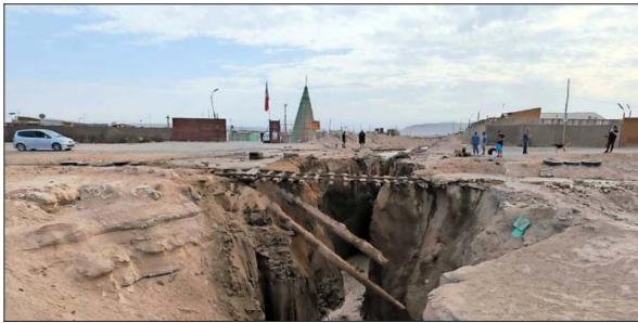
VÍA FÉRREA. — El socavón dañó la vía férrea del tren Arica-Tacna, lo que obligó a suspender el servicio.
