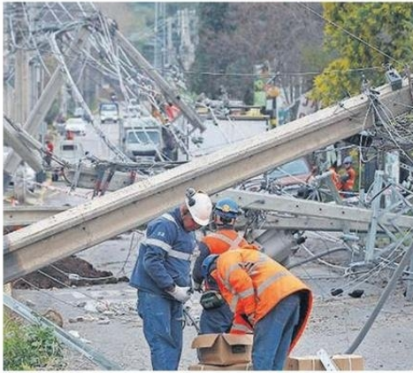
Producto de los vientos, se cayeron varios postes.
