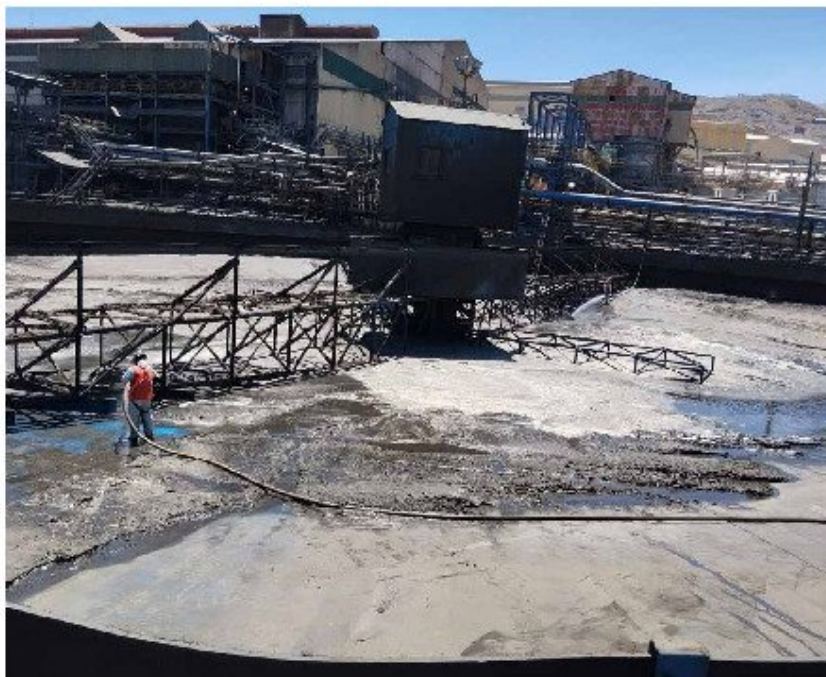
Los equipos operan 24/7 en El Teniente para no detener la operación.
