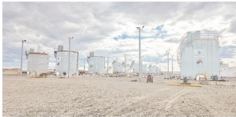
Planta de tratamiento de crudos de Gregorio Energy
