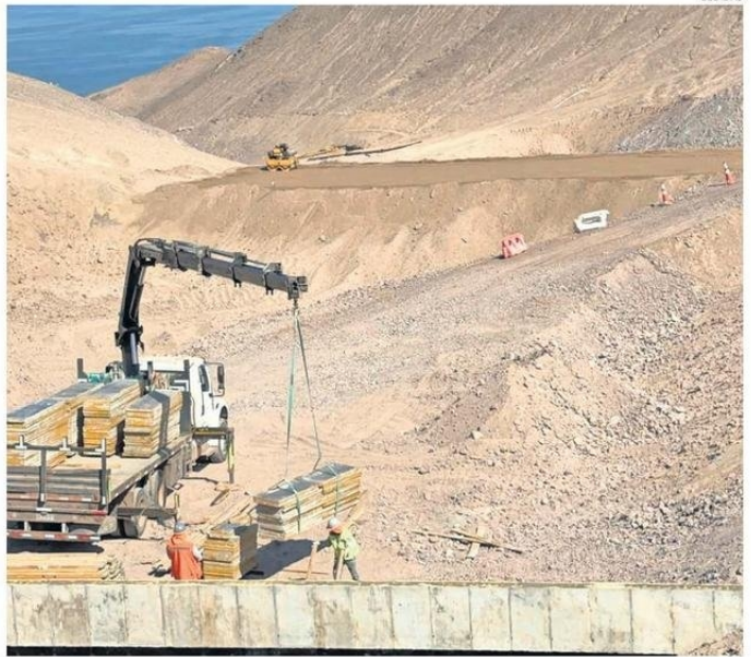
SE REALIZÓ LA CEREMONIA DE COLOCACIÓN DE LA PRIMERA PIEDRA DE LAS OBRAS.
