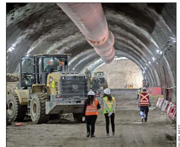
En las obras donde conectan AVO I y II, las faenas se extienden día y noche, todos los días de la semana.
