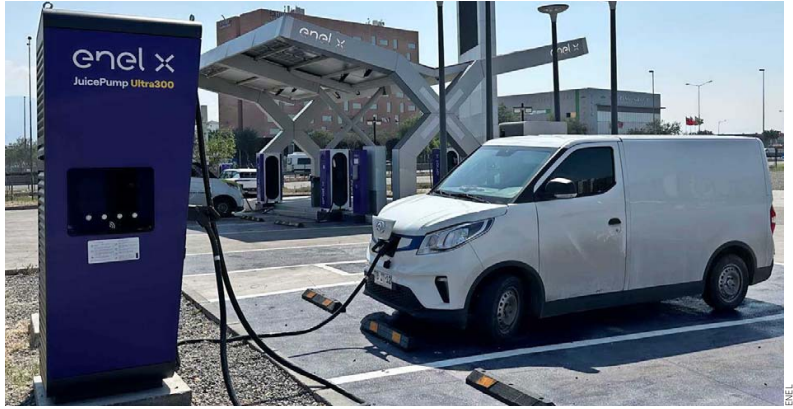
Electroestación Enea, de Enel X, en Pudahuel.
