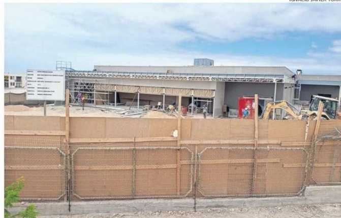
EN PLENO DESARROLLO ESTÁN LAS OBRAS DEL NUEVO UNIMARC DE CALDERA, A PASOS DEL CESFAM LOCAL.
