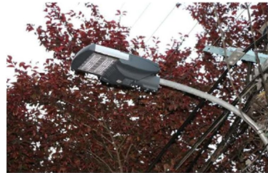
LAS LUMINARIAS LED fueron instaladas en 2019 en la comuna de Los Ángeles.
