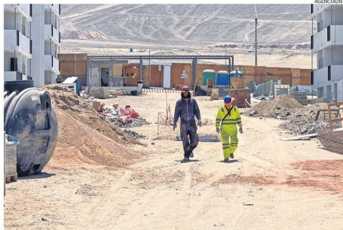
LOS PROYECTOS ALTO PARINACOTA, ALTO DEL SOL Y LICANCABUR ESTÁN A CARGO DE LA CONSTRUCTORA PACAL.
