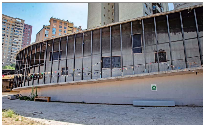
DETERIORO. — Aunque el edificio no sufrió daños estructurales con los incendios, sus paredes siguen cubiertas por hollín y sus columnas lucen desnudas por el impacto de las llamas.
