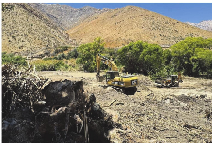
La maquinaria se encuentra trabajando buscando encontrar una pronta solución al corte del suministro a causa de los daños sufridos en el sistema de APR de La Jarilla-Pisco Elqui.
