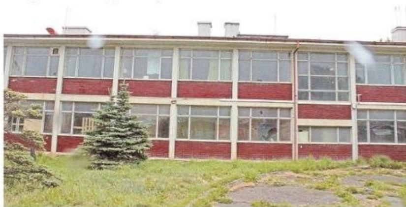
Estado actual del exhospital de la capital provincial de Última Esperanza.
