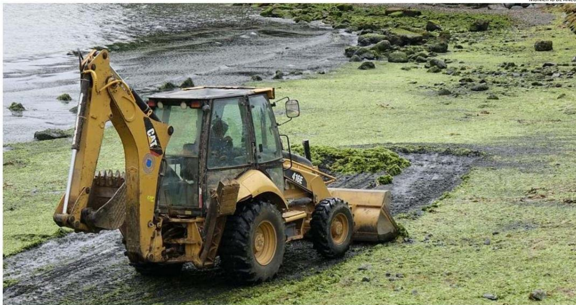
LA SEGUNDA SEMANA DE ENERO SE VIVió OTRO EPISODIO DE MALOS OLORES POR LA ACUMULACIÓN DE ALGAS EN LA PLAYA FÁTIMA. CON MAQUINARIA SE EXTRAJO MATERIAL.
