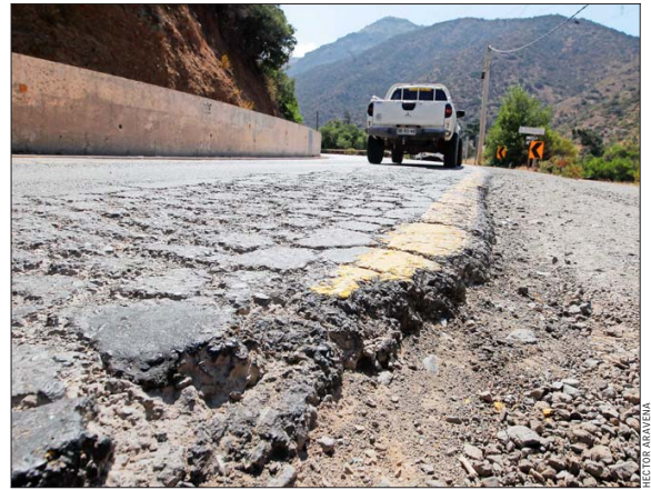
Problemas En la ruta hay problemas de pavimentación, daño en las barreras de contención, además de rodados de piedra, sobre todo tras las intensas lluvias y nevadas del 2024.
