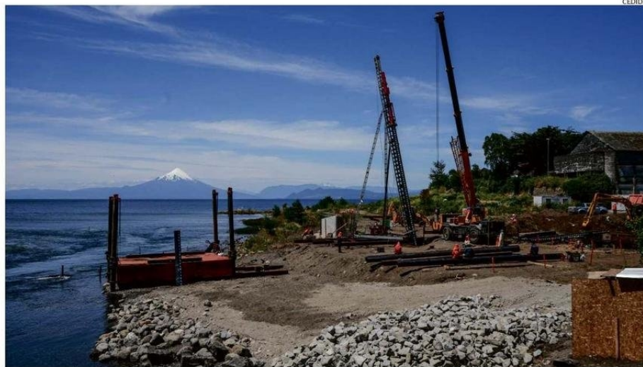
LAS OBRAS ESTÁN AVANZANDO EN EL TRAMO 1, QUE INCLUYE UNA PASARELA PEATONAL QUE CRUZARÁ EL RÍO MAULLÍN.
