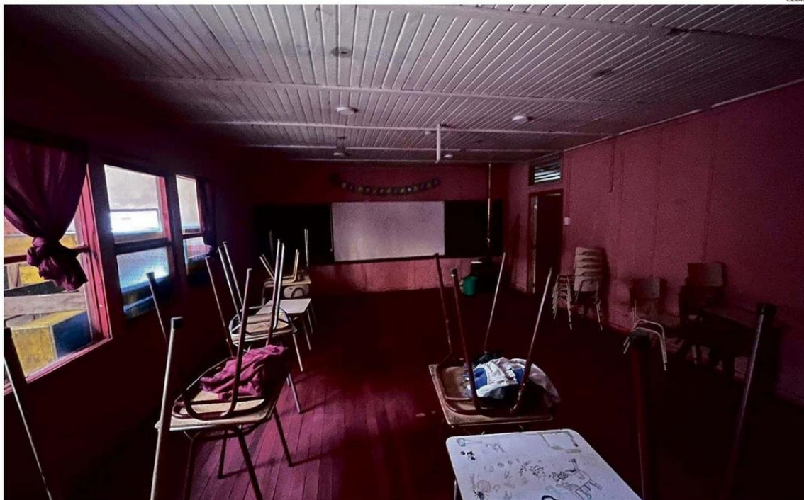
GOTERAS EN LOS TECHOS Y PAREDES DE SALAS DE CLASES, HAN DETERIORADO ESA INFRAESTRUCTURA DEL COLEGIO DE DIFUSIÓN ARTÍSTICA LOS ULMOS, EN LA COMUNA DE LOS MUERMOS.
