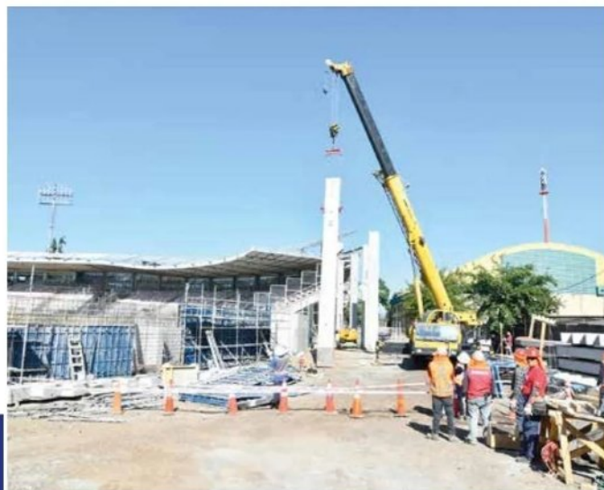
CURICÓ. A raíz de la construcción de la etapa final del estadio La Granja, se dio a conocer que dicho recinto no recibirá eventos masivos durante el año en curso. Diversas autoridades visitaron las obras, que a la fecha presentan un 20% de avance.
