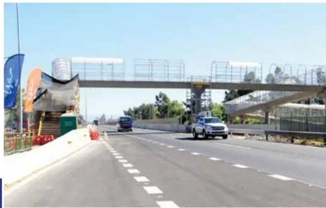
CURICÓ. A fin de mes estaría operativa la nueva pasarela peatonal en el sector Vista Hermosa, un anhelo planteado desde hace años por vecinos. Dicha estructura permitirá poder cruzar con seguridad la Ruta 5 Sur, a la altura del kilómetro 179.
