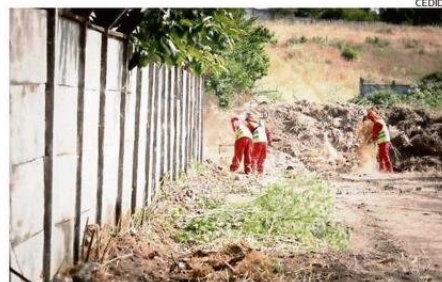
EL DESPEJE DE ESTA FRANJAS ES VITAL ANTE EL RIESGO DE INCENDIOS.
