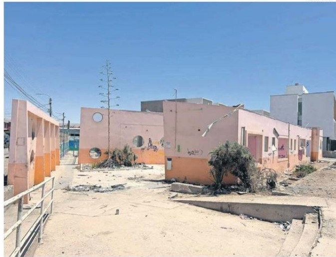
EL RECINTO EDUCACIONAL QUE ESTÁ AFECTADO POR SOCAVONES.
