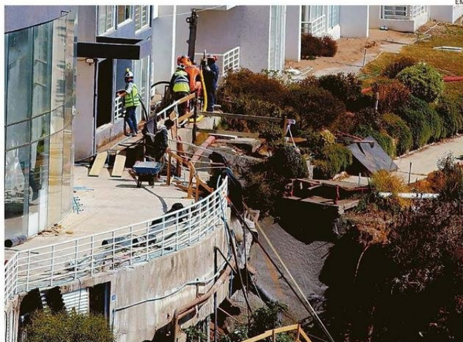
TRAS EL SOCAVÓN, UN INFORME MUNICIPAL ALERTÓ EL RIESGO DE "COLAPSO Y DERRUMBE" DE LA TORRE.
