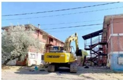
Desde diciembre se están ejecutando los trabajos de demolición de los bloques de departamentos en Villa Las Américas.
