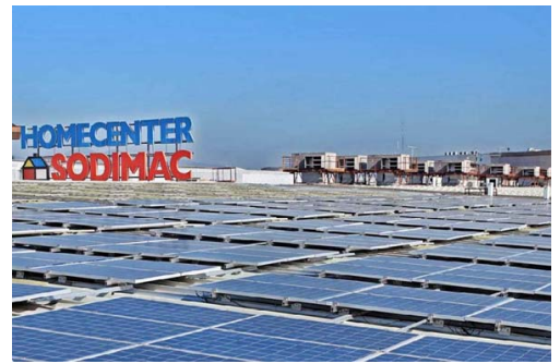
Reducción de emisiones a través del uso de paneles solares.
