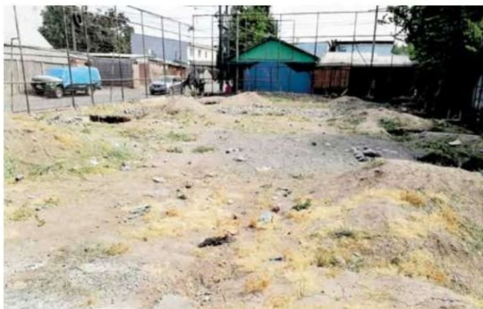
Las obras abandonadas de la multicancha de población Santa Lucía, han provocado accidentes.
