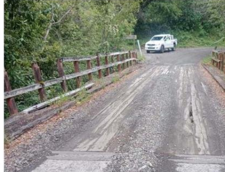
EN RUPANCO HAY PUENTES EN MAL ESTADO, COMO EN EL
