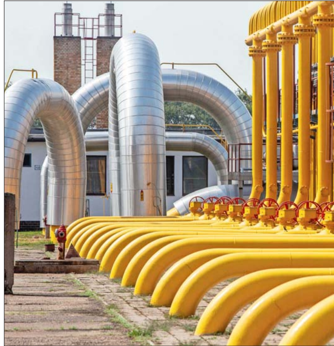
UNA ESTACIÓN de la red de gasoductos entre Ucrania y Eslovaquia.
