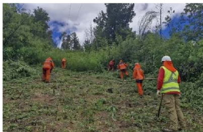
Junto a la comunidad y con todos los recursos en terreno la compañía avanza para asegurar el mantenimiento de su red eléctrica.
