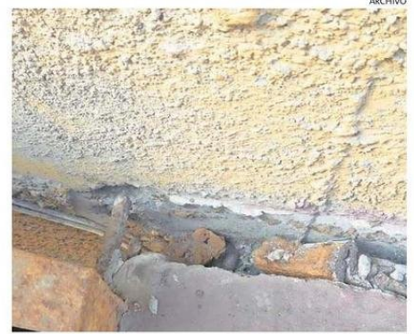
HAY DAÑOS ESTRUCTURALES EN EDIFICIOS, ESCALERAS Y VIVENDAS.
