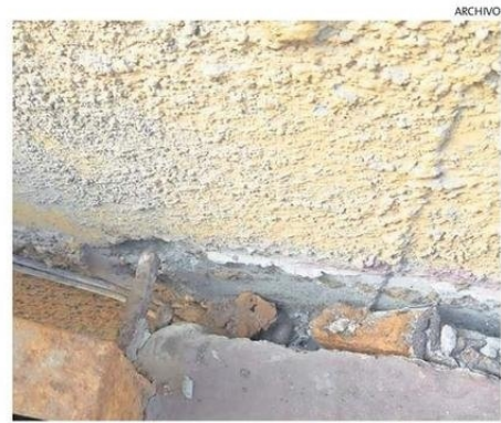
HAY DAÑOS ESTRUCTURALES EN EDIFICIOS, ESCALERAS Y VIVIENDAS.
