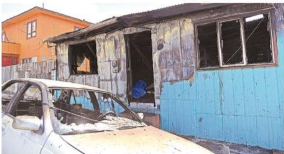
Totalmente consumida resultó esta vivienda y el vehículo también resultó con daños. Labocar se constituyó en el lugar para realizar las pericias del incendio.
