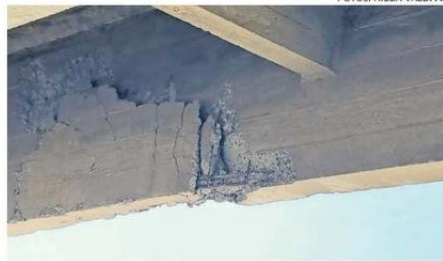
DAÑO HABRÍA SIDO PROVOCADO POR UN CAMIÓN.
