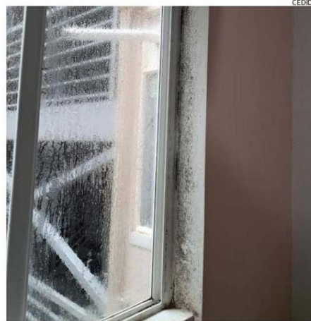
LA HUMEDAD SE CONDENZA EN LAS VENTANAS, PRECISÓ ALBORNÓZ.
