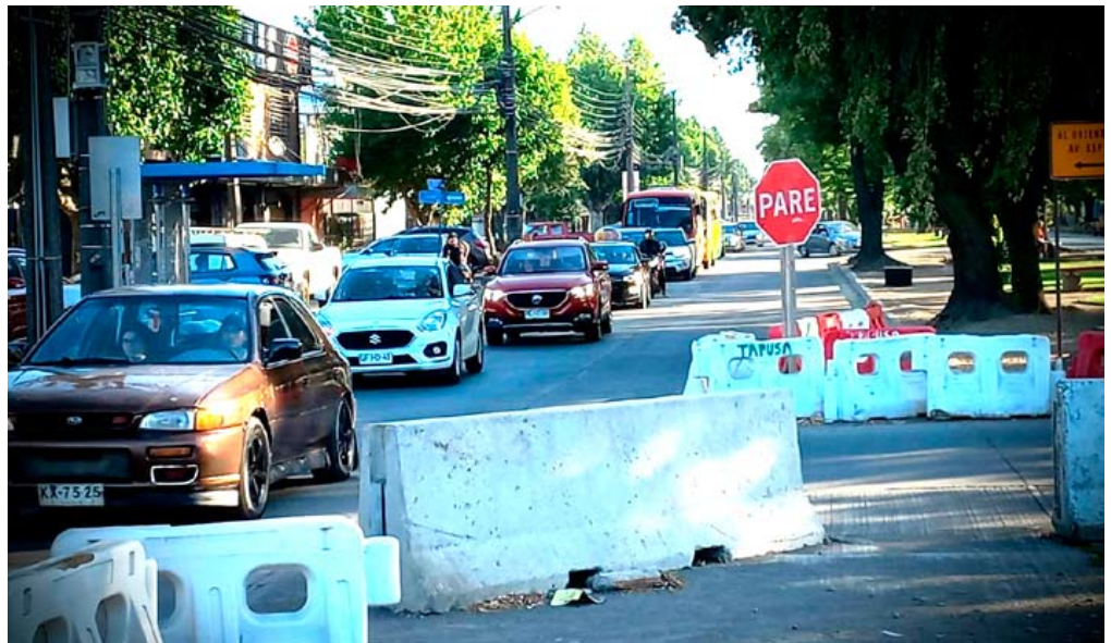
Colector, en el punto de descarga, se encuentra socavado justo debajo del viaducto.
