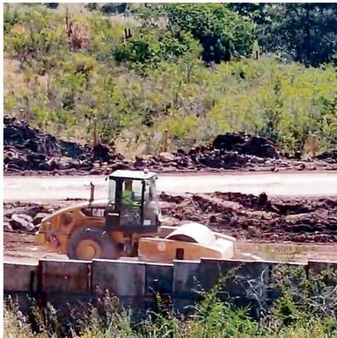
LOS TRABAJOS EN EL SECTOR DE SAN JUAN PARTIERON EN FEBRERO CON MOVIMIENTOS DE TIERRA.
