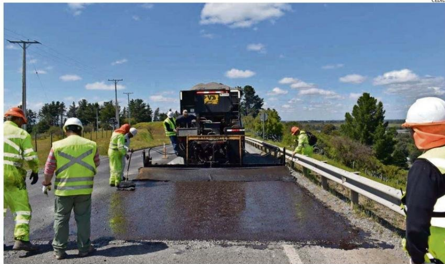
CÁMARA CHILENA DE LA CONSTRUCCIÓN APUNTA A QUE EL PRÓXIMO AÑO DEBE SER UNO EN EL QUE SE CONCRETEN GRANDES OBRAS.
