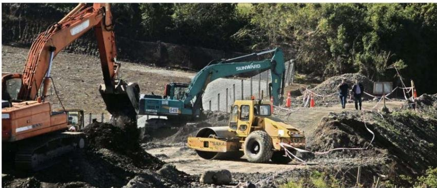
EN PUERTO VARAS SIGUEN CON LAS LABORES EN EL TALUD UBICADO EN LA POBLACIÓN MICHELLE BACHELET 2.
