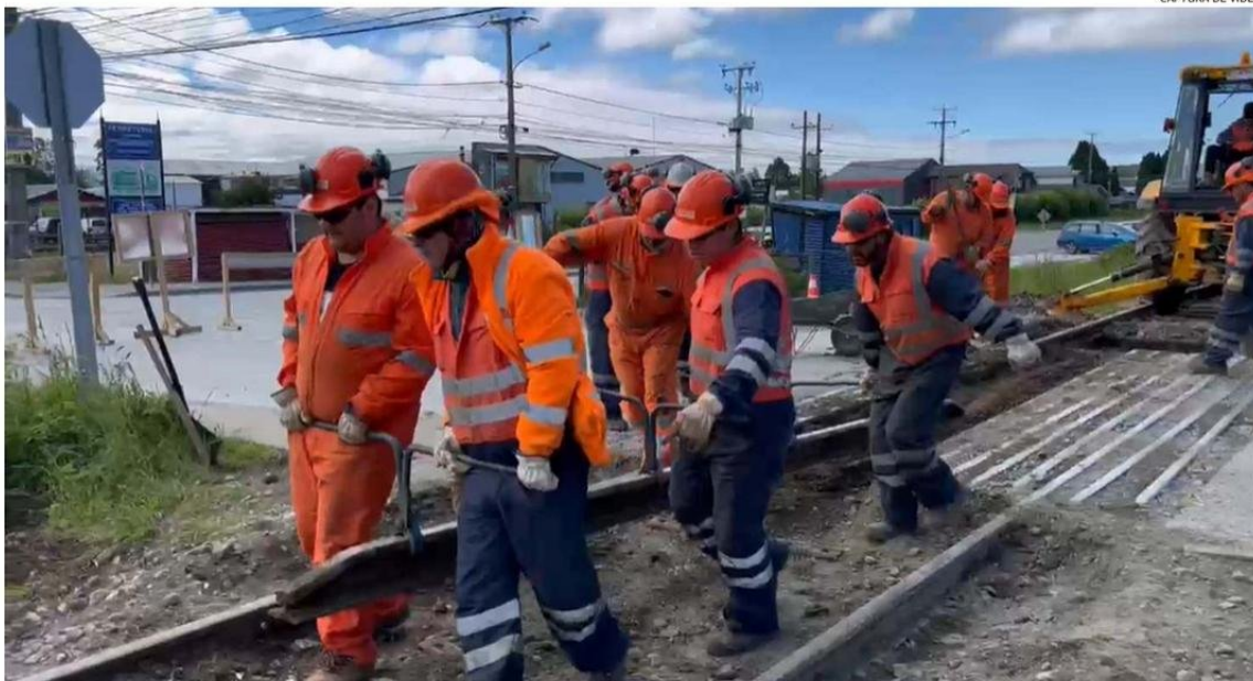
DURANTE LOS ÚLTIMOS DÍAS, LOS TRABAJOS DE EFE HAN ESTADO LOCALIZADOS EN LOS CRUCES FERROVIARIOS, COMO EL DE LA VARA.
