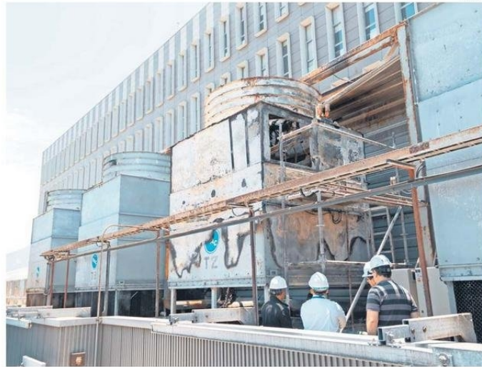
SIGUE LA INVESTIGACIÓN SOBRE EL ORIGEN DEL INCENDIO QUE AFECTÓ AL HOSPITAL REGIONAL.
