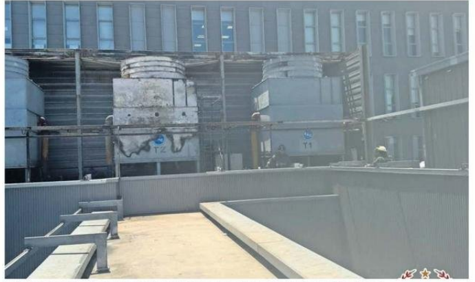
ASÍ QUEDÓ EL LUGAR DONDE FUE EL INCENDIO Y SE INVESTIGA EL POR QUÉ OCURRIÓ.
