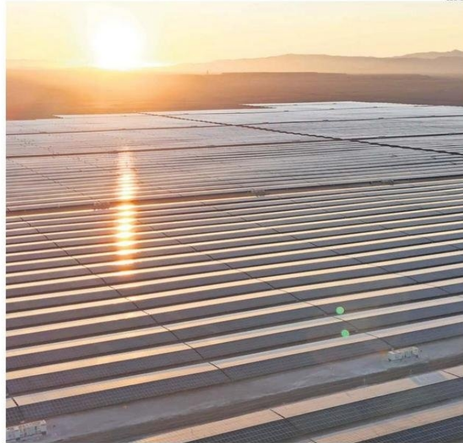
EL PARQUE, QUE AVANZA EN SU SEGUNDA ETAPA, ESTÁ UBICADO A UNOS SIETE KILÓMETROS DE MARÍA ELENA.
