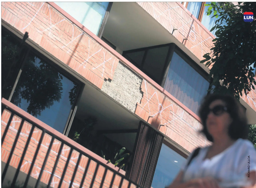
La fachada luce rayada y con grandes paños en que se ha desprendido la chapa de ladrillo.
