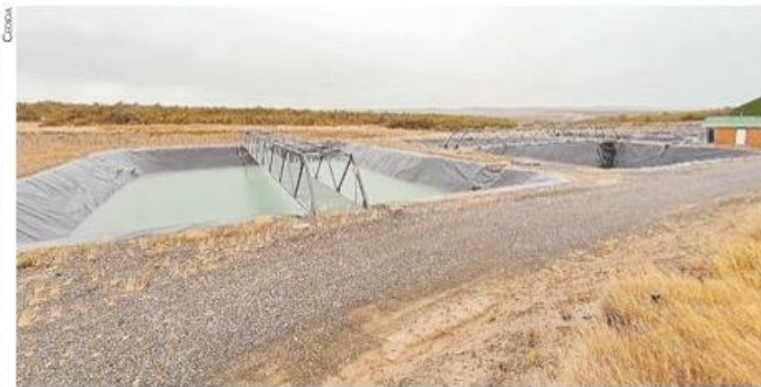
A más de tres años de terminadas las obras, aún no se puede utilizar el relleno sanitario.
