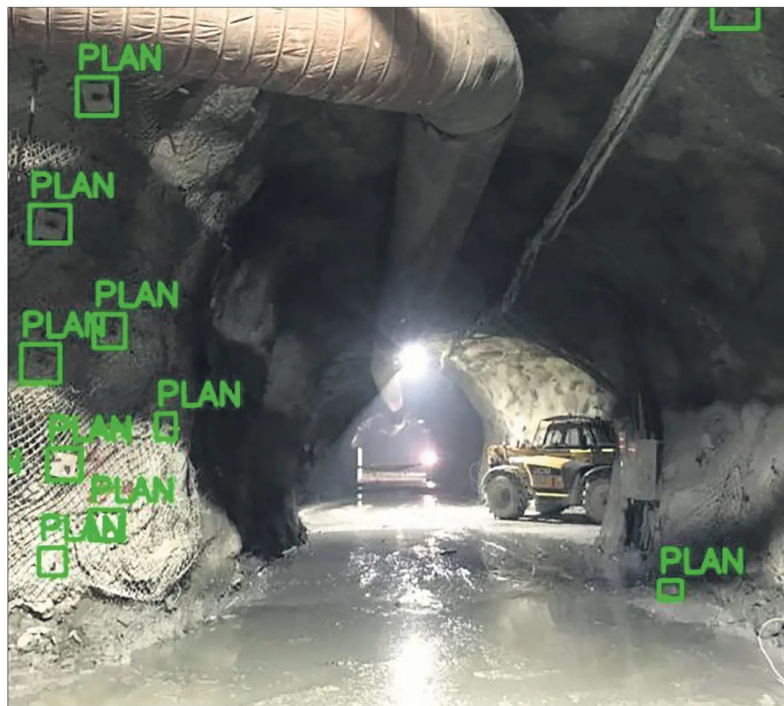
TwinViz detecta fallas específicas en pernos y planchuelas, como cortes, mal posicionamiento o daños.
