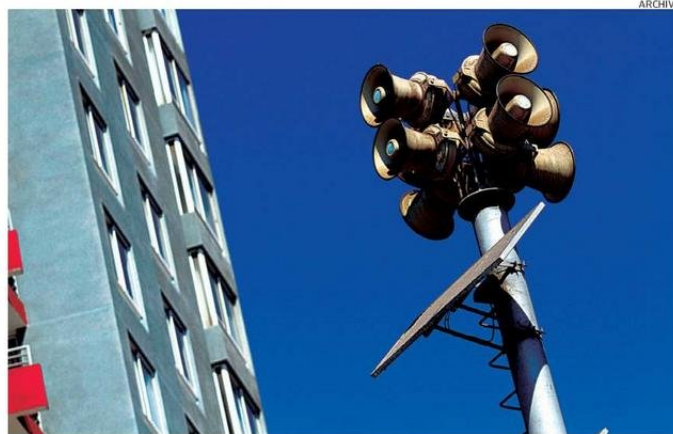
ESTE NUEVO SISTEMA CONTEMPLA POSTES DE ACERO DE 11 METROS DE ALTURA.
